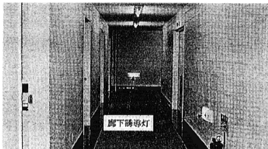
図3 廊下における誘導灯の設置状況(工学部2号館6階)
